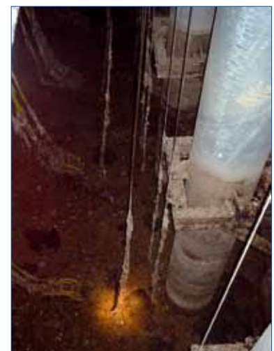
Рис. 5.3: Образование плавающей корки в зумпфе насосной станции
