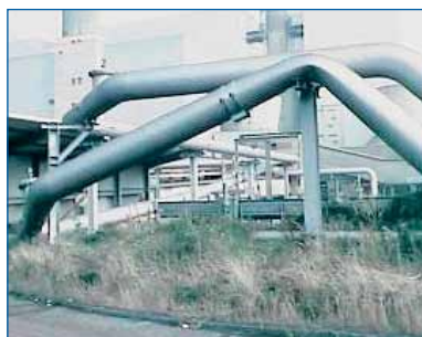
Рис. 1-а: Полностью разрушенная напорная труба DN 600 (толщина стенок 12 мм)
