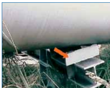
Рис. 1-б: Разрушенный суппорт (двухавтовый профиль 200 мм окончательно деформирован)
