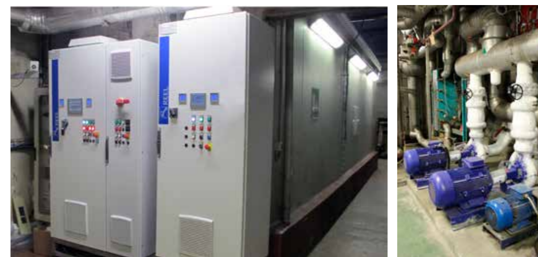
Quadri di comando e controllo circuito degasatore e impianto di pompaggio equipaggiato con motori SuPremE per il circuito raffreddamento glicole presso stabilimento Galbani
