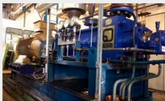
Efficientamento di una pompa con l'installazione del motore SuPremE.
