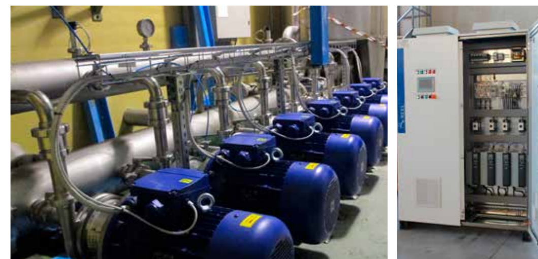
Quadri di comando e controllo e motori SuPremE in un impianto di pompaggio presso uno stabilimento di produzione di acqua minerale
