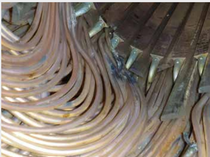
Durchgebrannte Wicklung des Unterwassermotors
