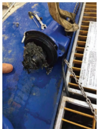
部件拆下后，发现过滤器全是堵塞杂质
