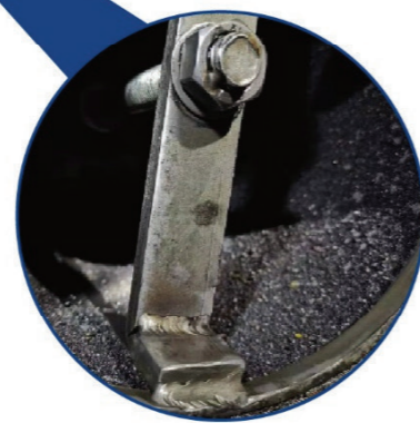
现场检查，过滤器堵塞
