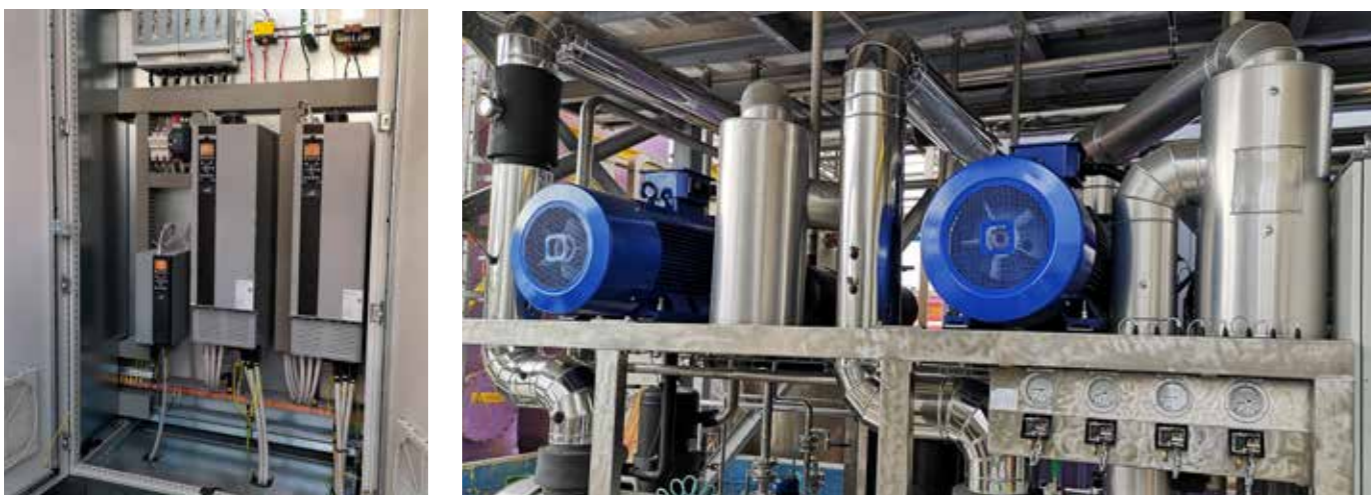
Motori SuPremE ad alta efficienza (a destra) e relativo quadro di comando e controllo equipaggiato con inverter KSB202 (a sinistra) a bordo di una centrale frigorifera con compressori semi-ermetici.
