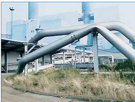
Abb. 1: Völlig zerstörte Druckrohrleitung DN 600 (Wandstärke 12 mm)
