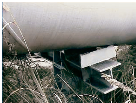
Abb. 2: Zerstörtes Auflager (Doppel-T-Profil 200 mm bleibend verformt)
