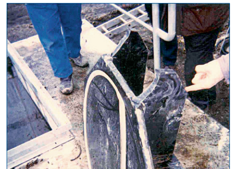
Abb. 3: Rückflussverhinderer DN 800 nach Druckstoß in der Druckrohrleitung
