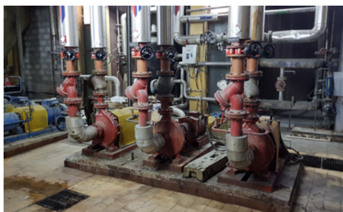
Exemple de réalisation dans une Unité de Varlorisation de l'Energie. Pompes alimentaires de chaudière. Avant audit et travaux : rendement moyen = 20%
