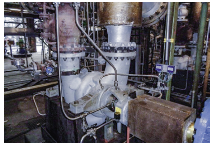
Pompe après opérations de rétrofit en 2020
