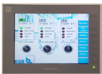
HMI avec synoptiques process.
