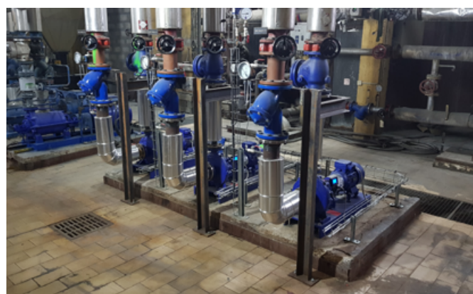
Après audit et travaux : rendement moyen = 70%
