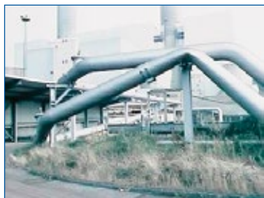
Illustration 1-a : Tuyauterie de pression DN 600 totalement détruite (épaisseur de paroi 12 mm)
