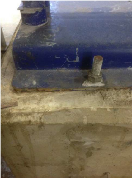
Photo : Un mauvais alignement risque même d'être à l'origine d'une fissuration de la fondation de la pompe.
