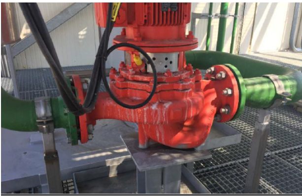
Photo : le bouchon d'étanchéité jaune est toujours intact
